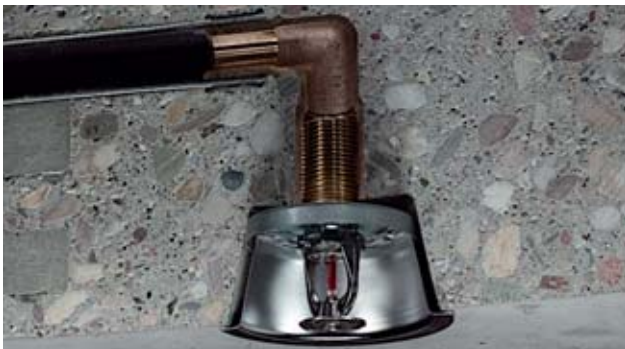
Einbetoniertes Undercover-Sprinklerrohrsystem – mit installiertem Undercover-Sprinkler
